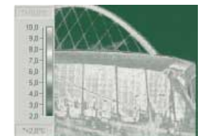
Thermografie-Aufnahmen machen Wärmelecks sichtbar (siehe Umschlagbild).
