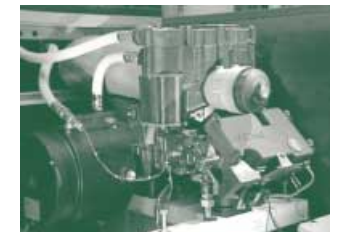
Herz eines Minikraftwerkes ist ein robuster Motor. Die Schläuche leiten das Kühl- bzw. Heizwasser ab.
